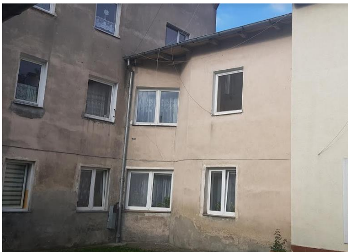
Fot.4. Bartoszyce, budynek mieszkalny ul. Kętrzyńska 25 – elewacja tylna, stan obecny. Fot. J.Baran.
