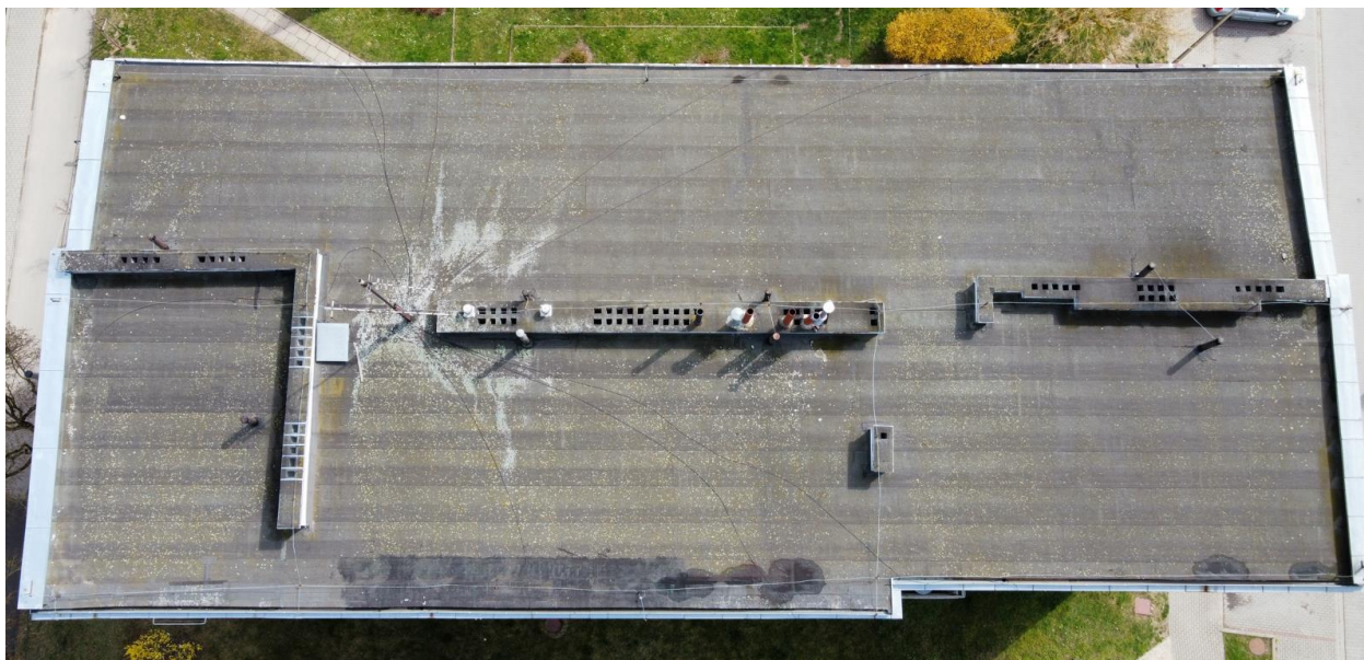
Fot. 4. Widok połaci dachowej.
