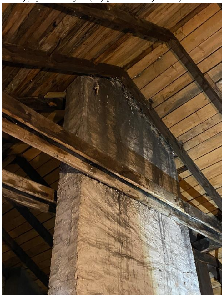
Fot. nr 8. Widok nieszczelności przy kominie.
