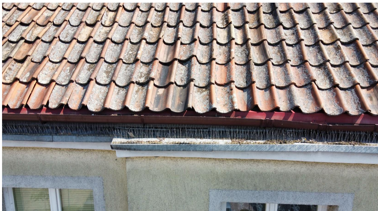
Fot. nr 4. Widok powyginanego orynnowania i nieszczelnego pokrycia dachowego
