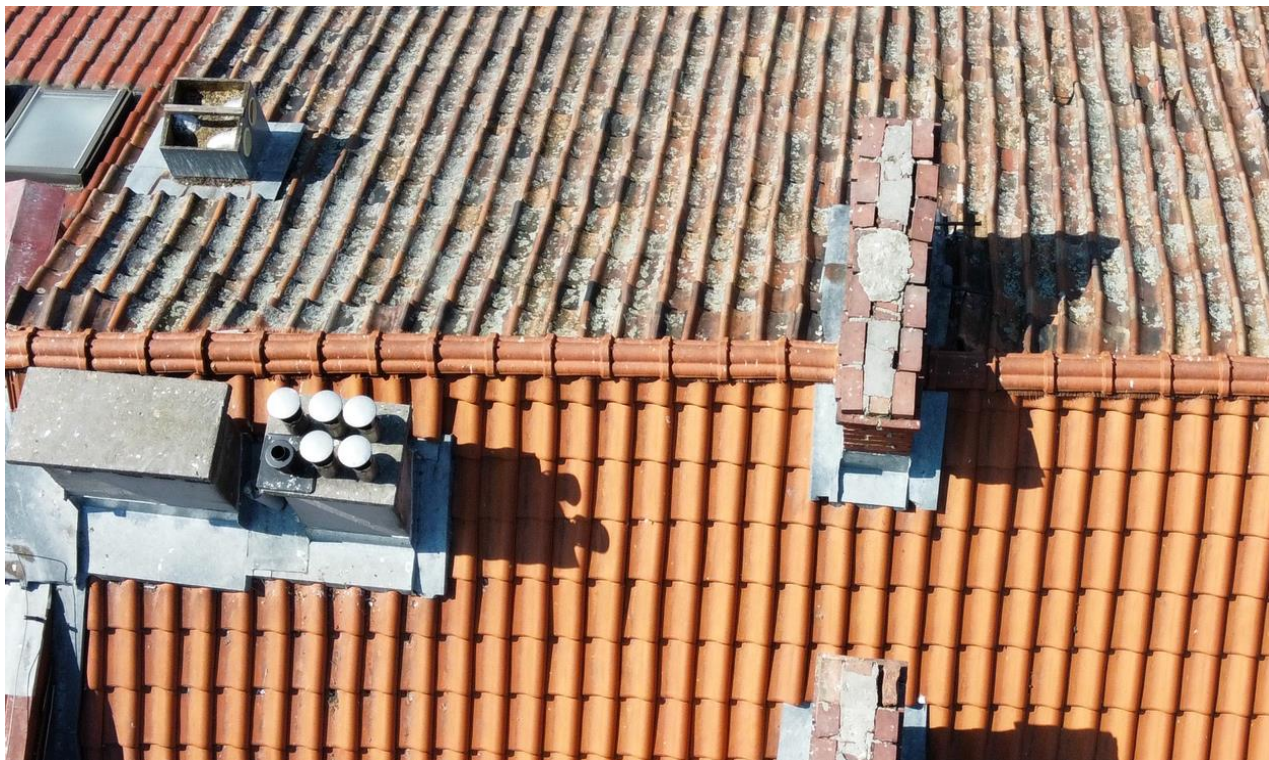
Fot. nr 5. Widok kominów wraz z kominem z brakującą czapą kominową.
