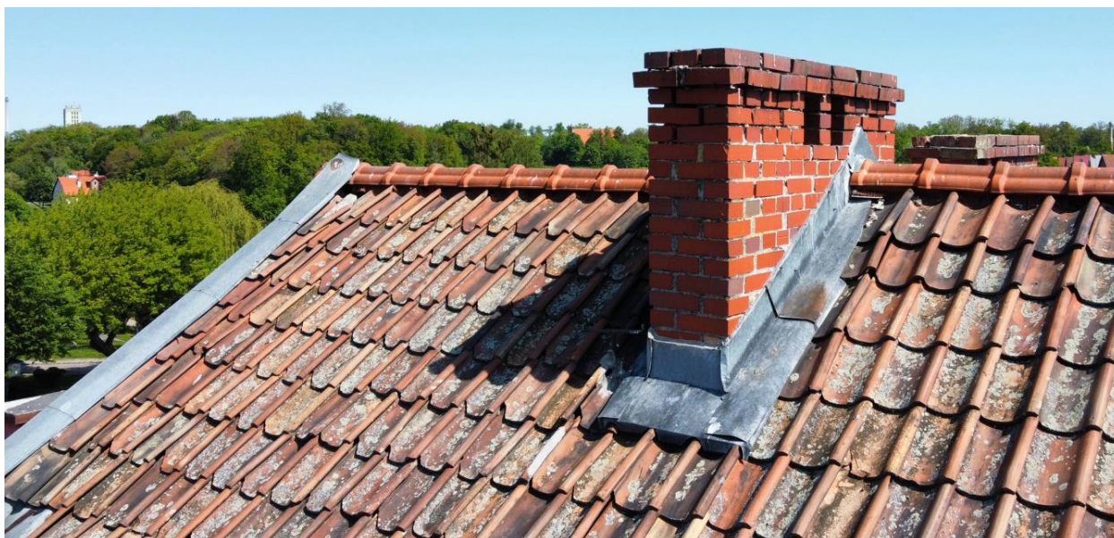
Fot. 12. Widok istniejących obróbek blacharskich.
