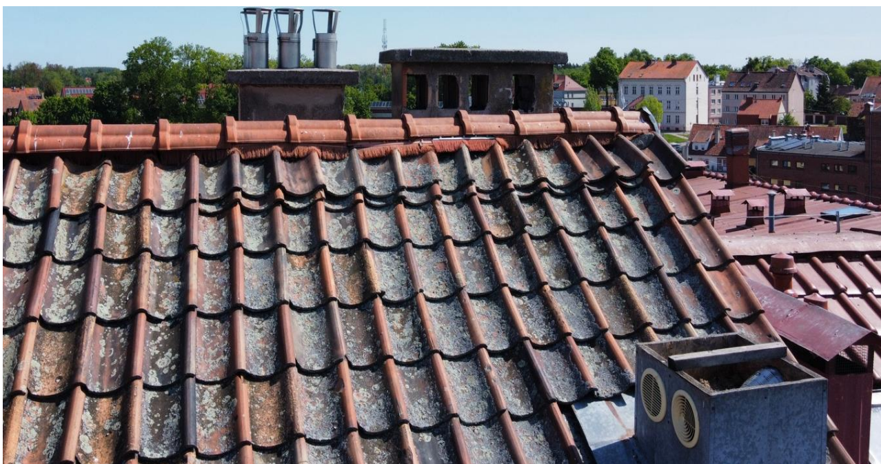
Fot. nr 8. Widok nieszczelnego pokrycia dachowego.
