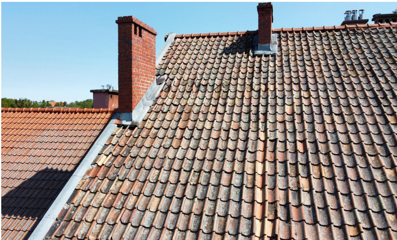
Fot. nr 7. Widok nieszczelego pokrycia połaci dachowej wraz z kominami.
