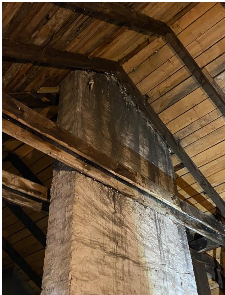
Fot. 13. Kominy z ubytkami tynku.
