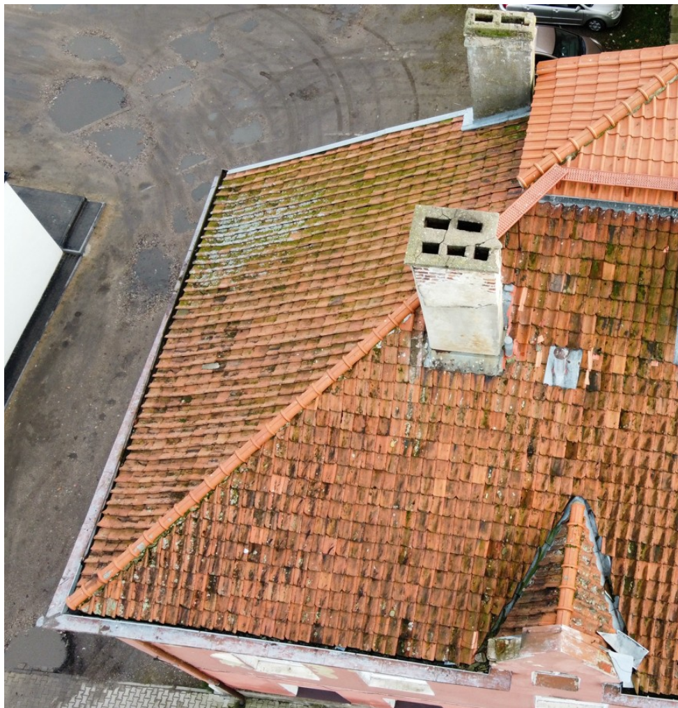
Fot. 14. Kominy przeznaczony do przemurowania.
