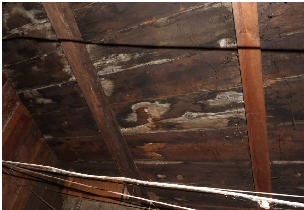
Fot. 7. Zawilgocone i porażone grzybem deskowanie.
