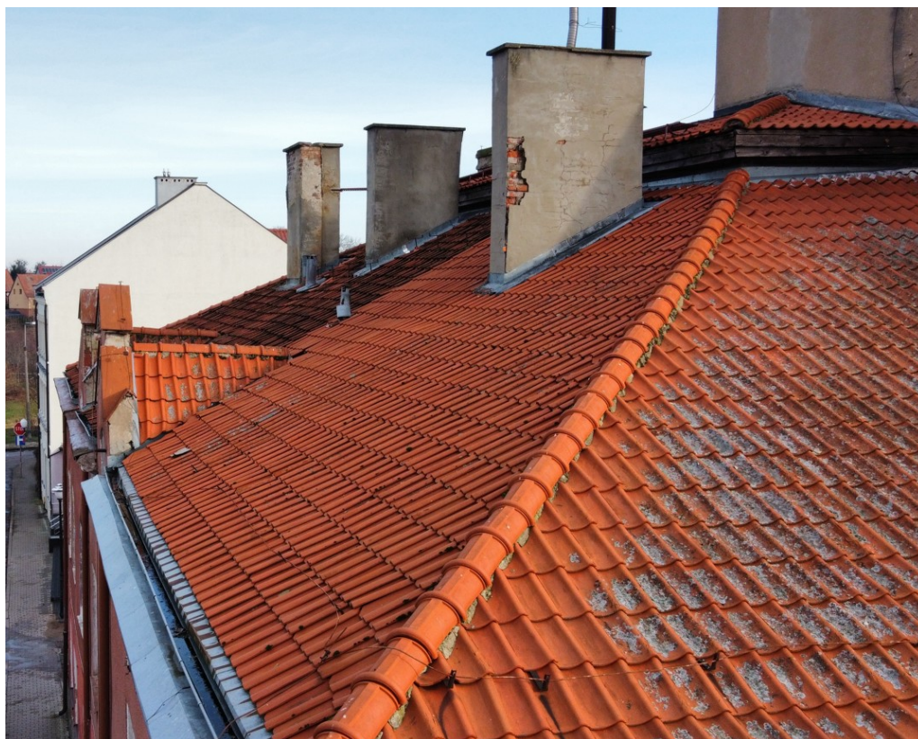
Fot. 13. Kominy z ubytkami tynku.
