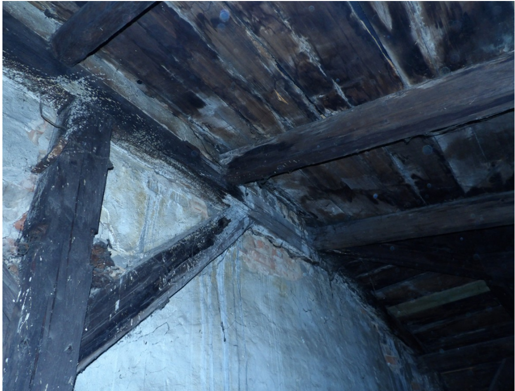
Fot. 3. Widok zawilgoconej i porażonej grzybem konstrukcji wieży wraz z deskowaniem.
