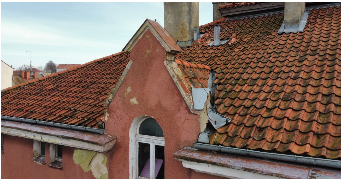
Fot. 12. Widok istniejących obróbek blacharskich.
