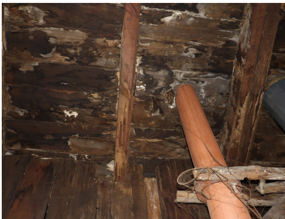
Fot. 8. Zawilgocone i porażone grzybem deskowanie.
