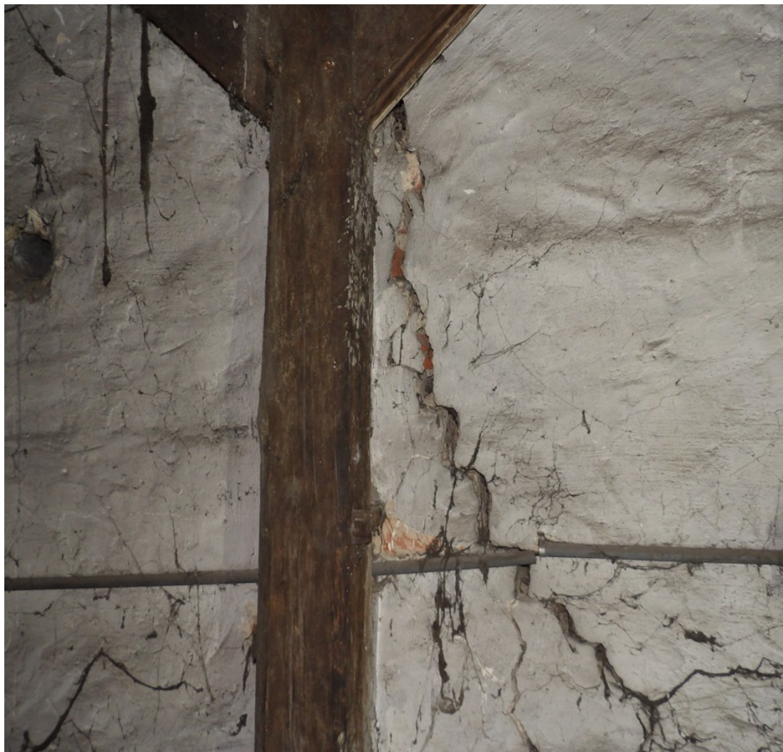
Fot. 10. Zarysowana ściana przeznaczona do naprawy.
