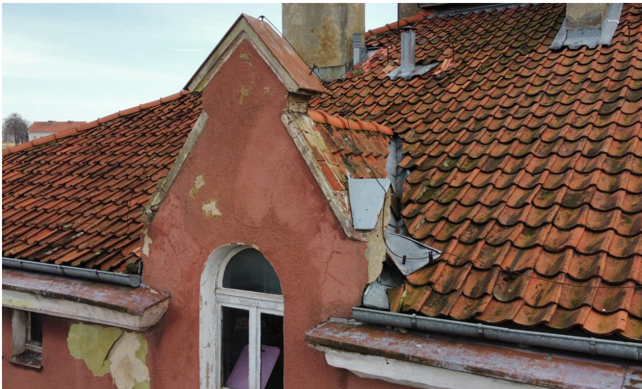
Fot. nr 8. Widok obróbek blacharskich i istniejącej instalacji odgromowej.
