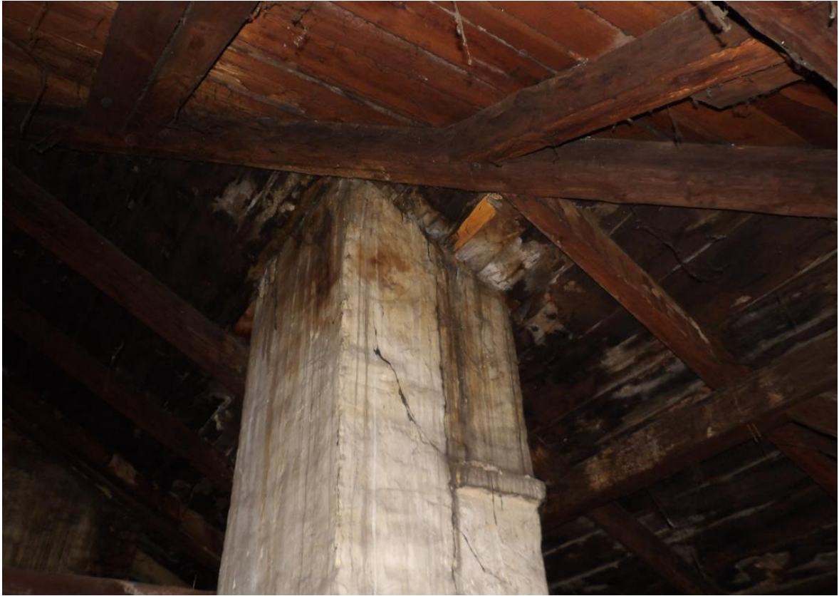
Fot. nr 18. Widoczne zawilgocenia i zapleśnienia przy kominie przeznaczonym do rozbiórki.
