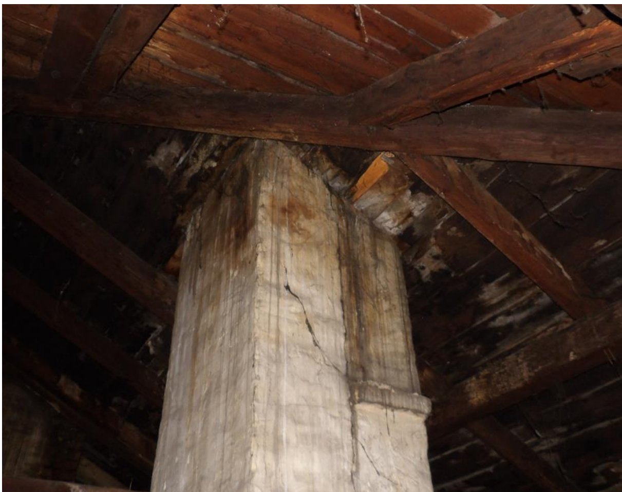
Fot. nr 11. Widok spękanego komina wraz z zawilgoconym deskowaniem wokół.
