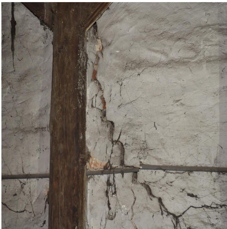
Fot. nr 15. Widok spękania ściany podlegającej naprawie od wewnątrz.
