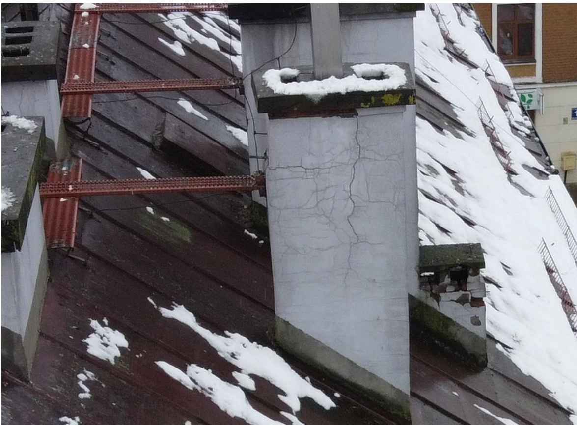
Fot. nr 8. Widok stopni kominiarskich oraz spękanych kominów.
