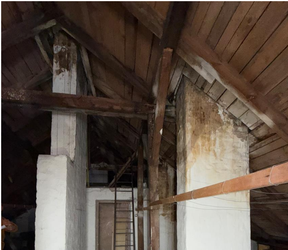
Fot. nr 14. Widok nieszczelności przy kominach.
