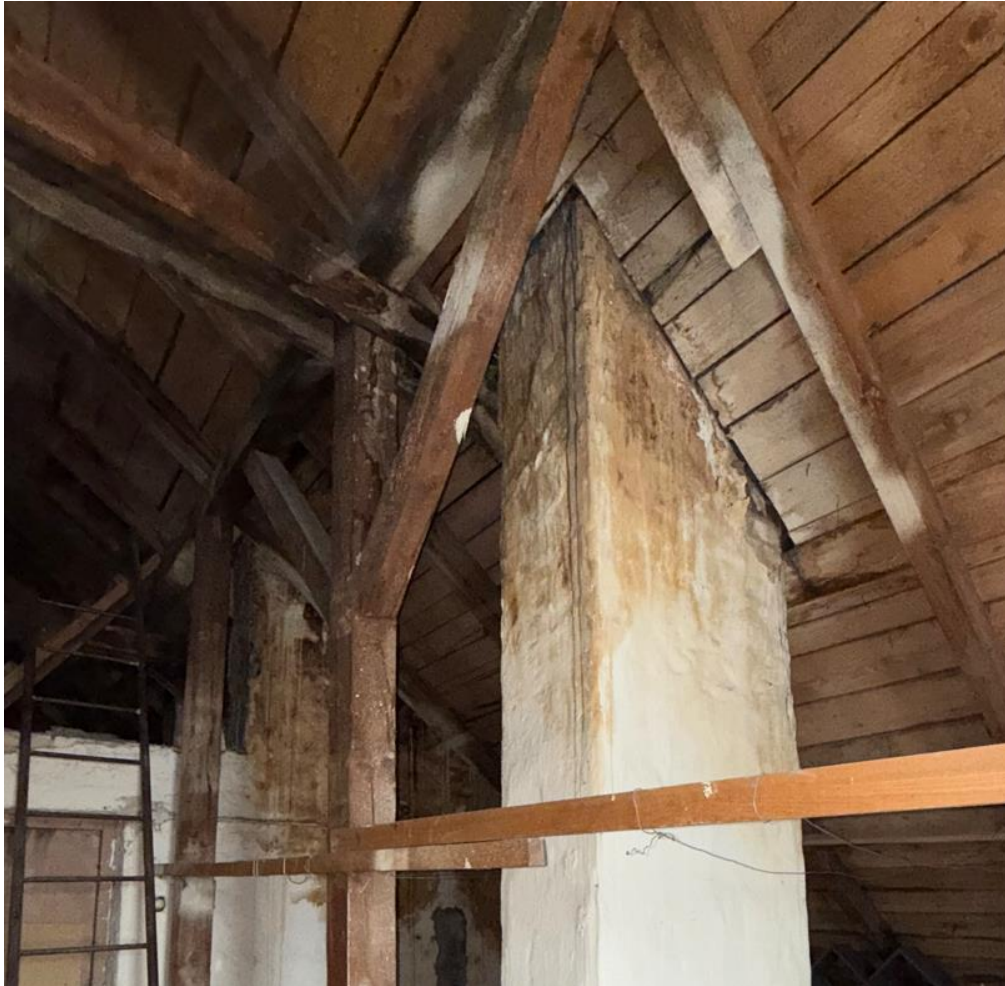
Fot. nr 13. Widok nieszczelności przy kominach.
