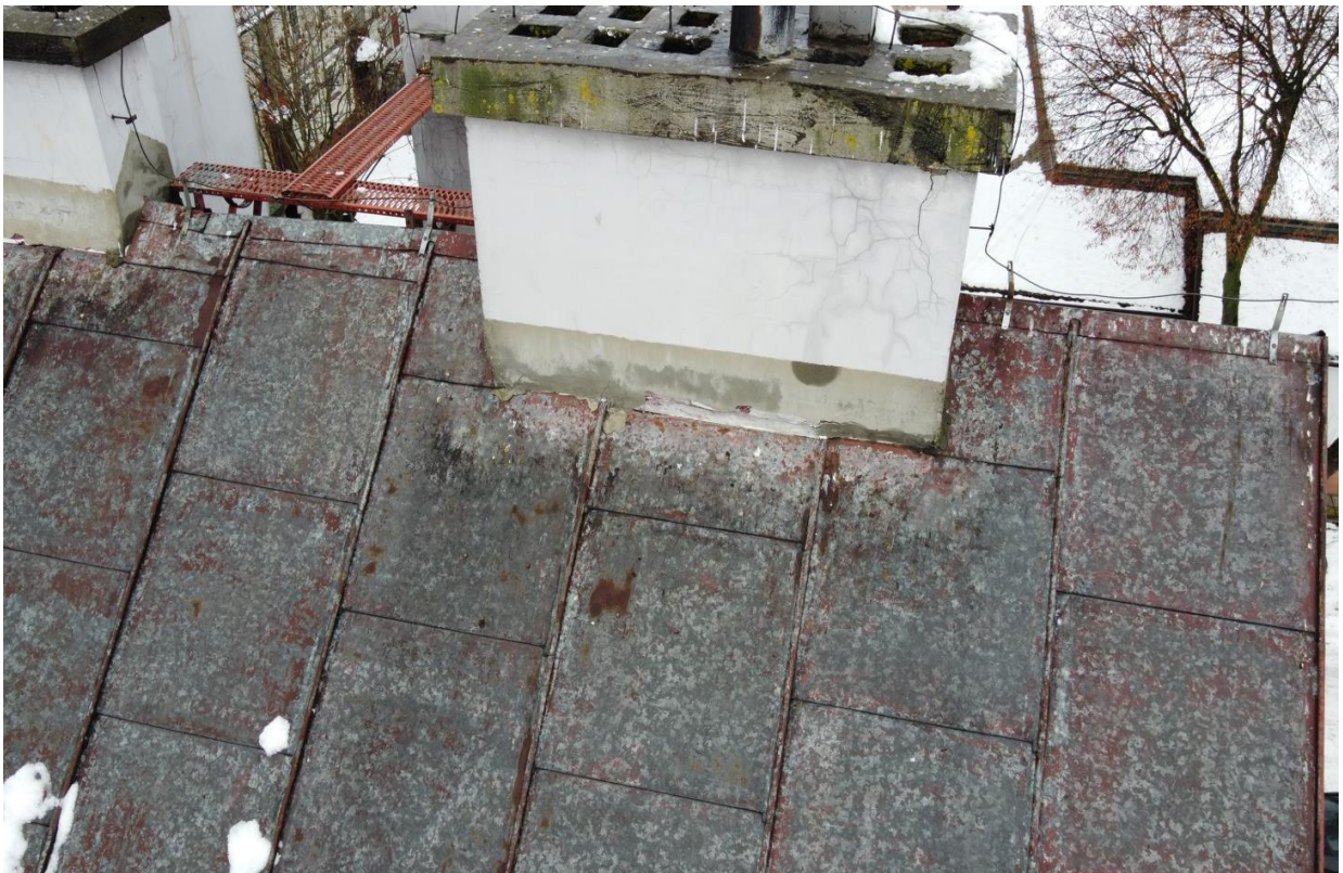
Fot. nr 7. Widok łuszczącej się farby na pokryciu dachowym.
