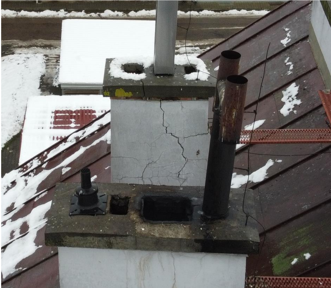
Fot. nr 9. Widok spękanych kominów.
