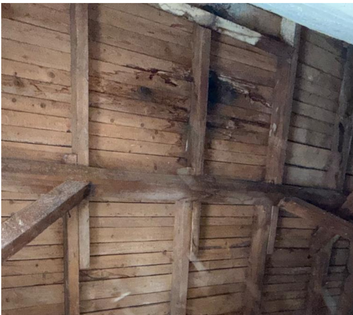
Fot. nr 16. Widok zawilgoconego deskowania.
